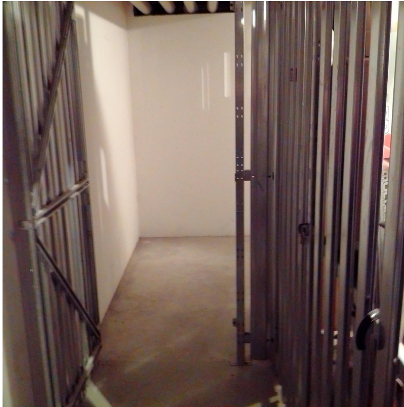
Eingang Abstell Raum - Gross
