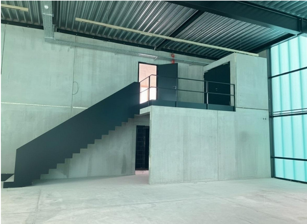
EG Technikraum, OG Serverraum
