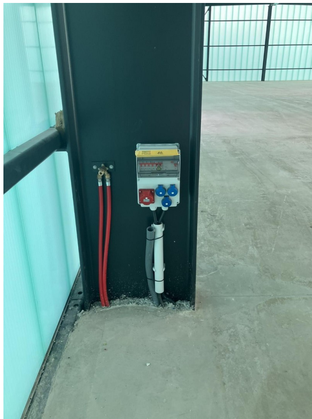
Verteiler an jeder Stütze
