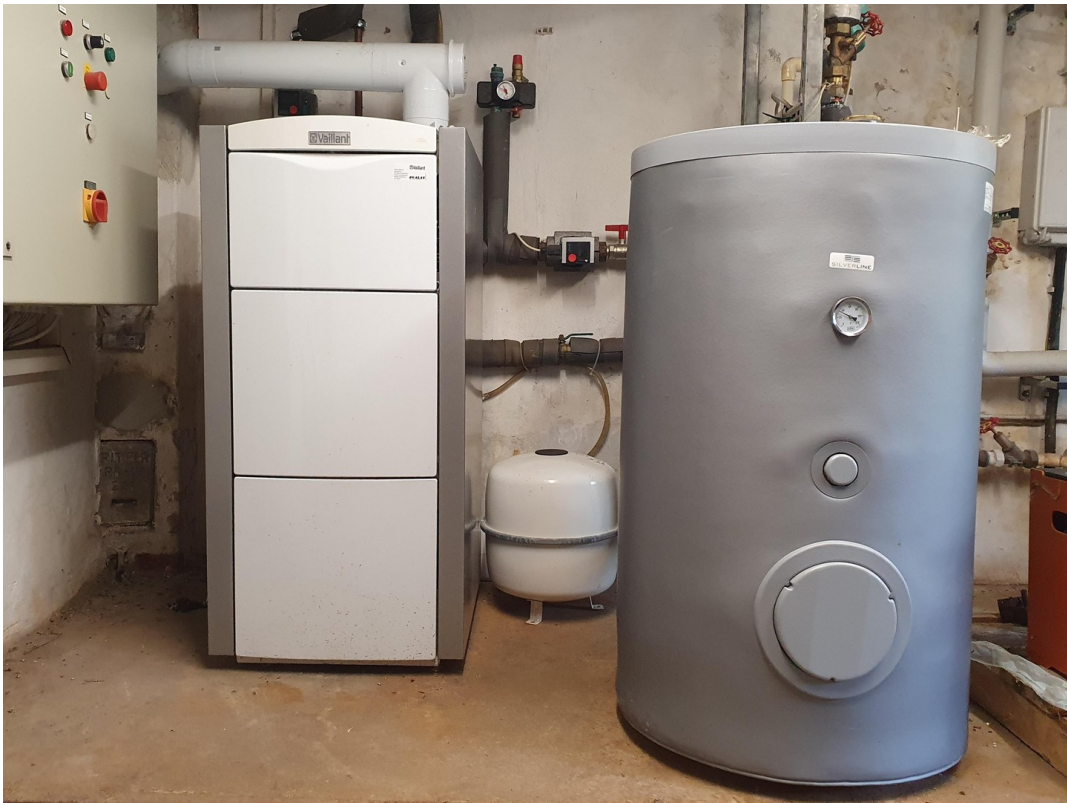
Heizung mit neuem W/W Speicher
