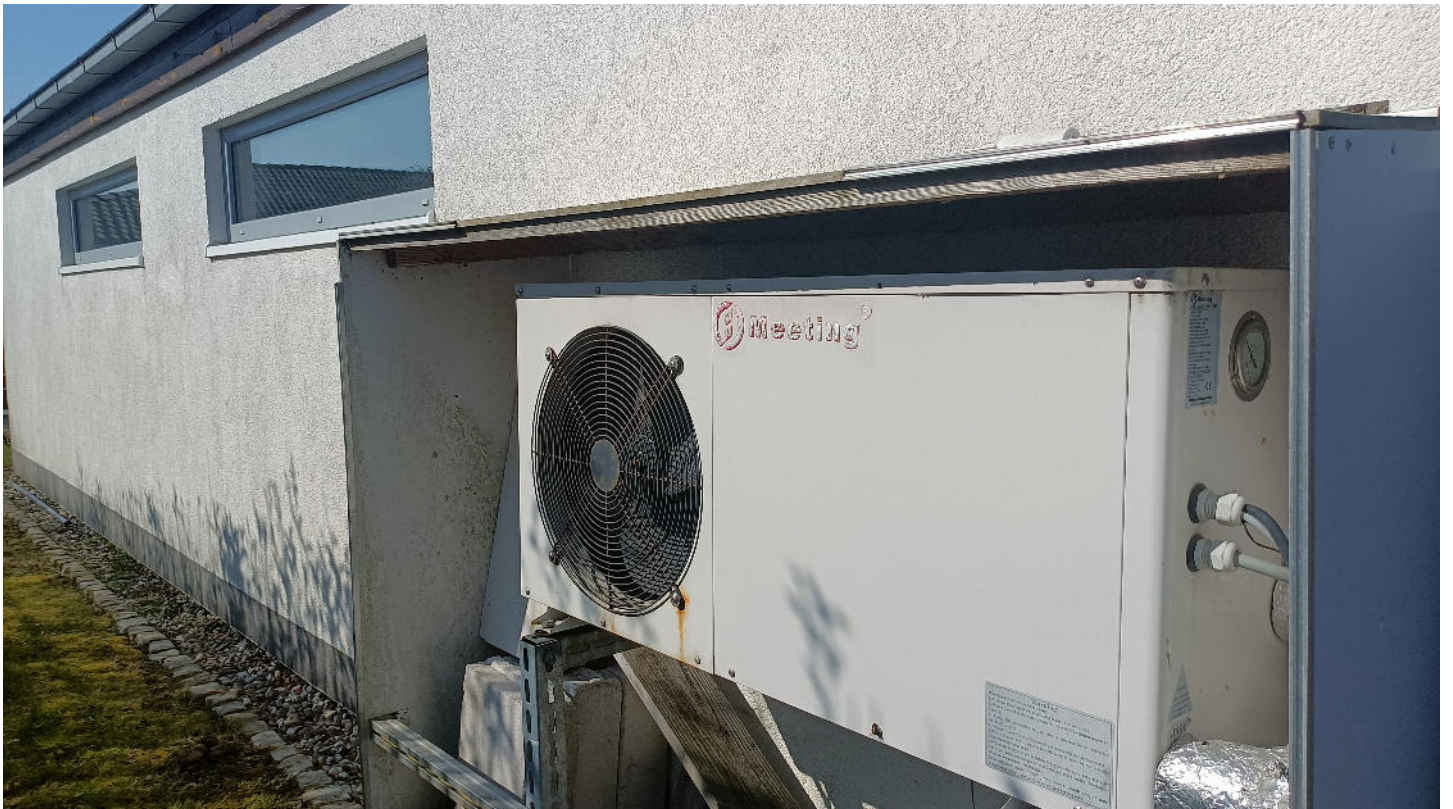
Luftwärmepumpe für das Nebengebäude
