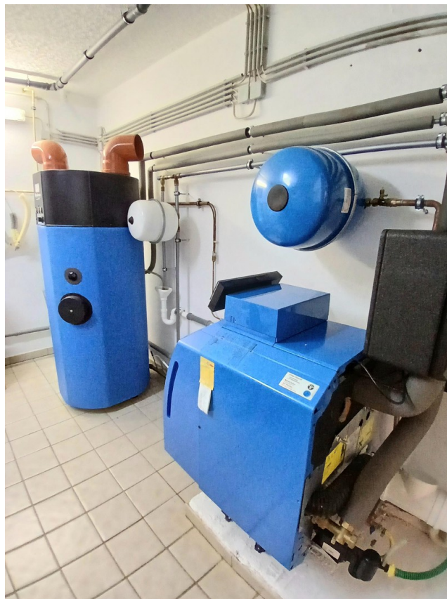
UG: Heizung und HWR
