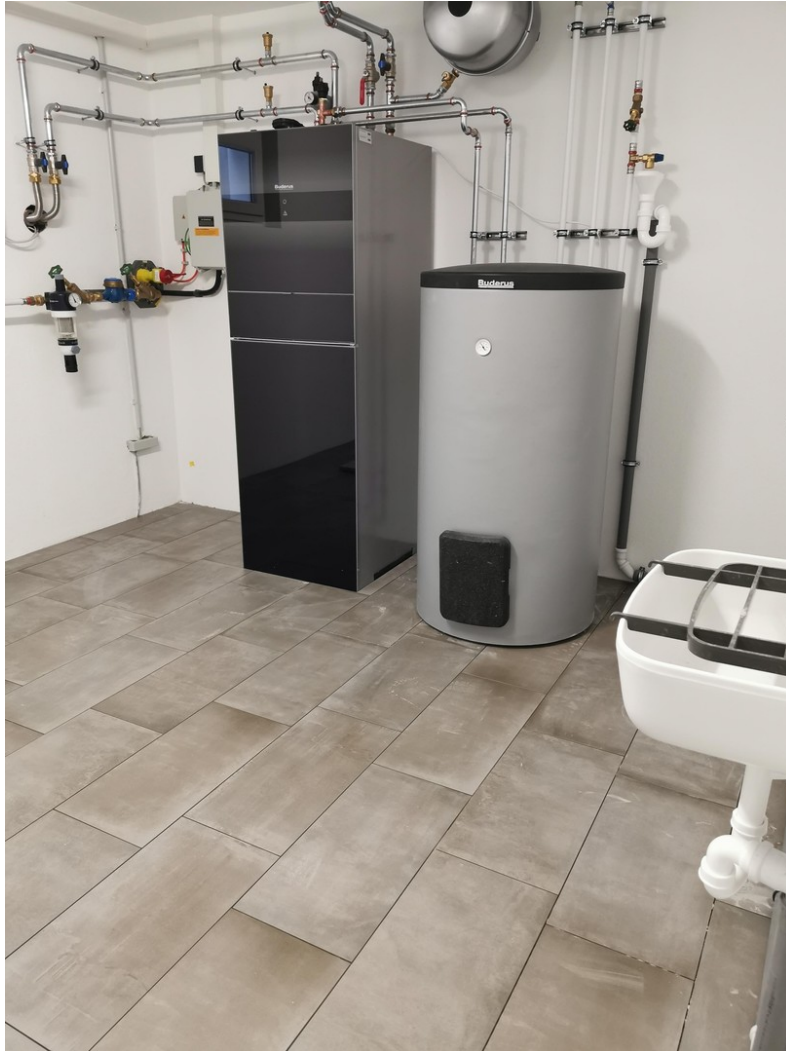
Kellerraum Technik und Wäsche
