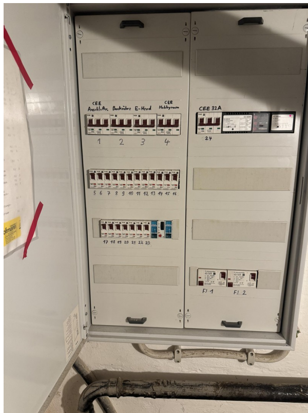
Schaltkasten mit 2 FI-Schalter
