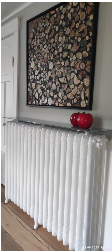
Alte gusseiserner Heizkörper
