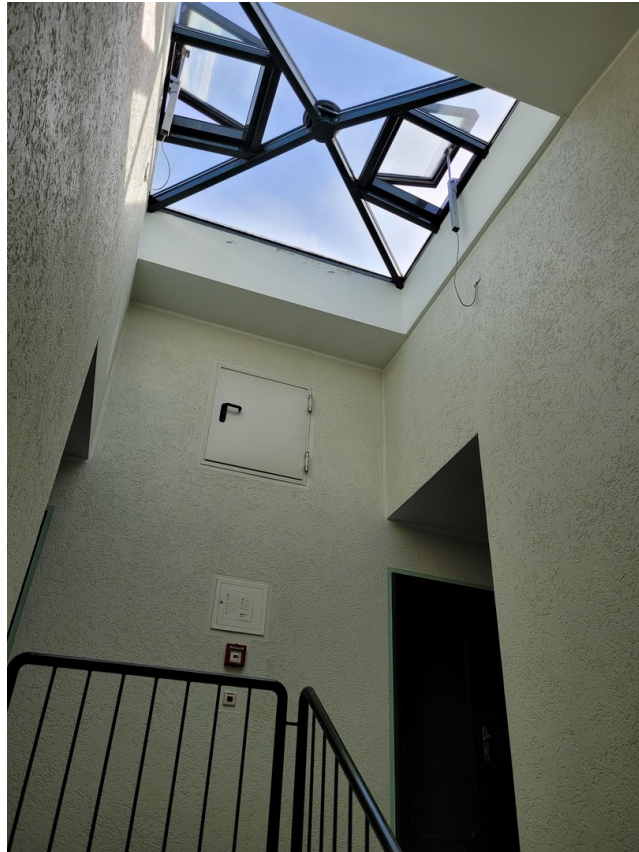
Treppenhaus mit Rauchabzug
