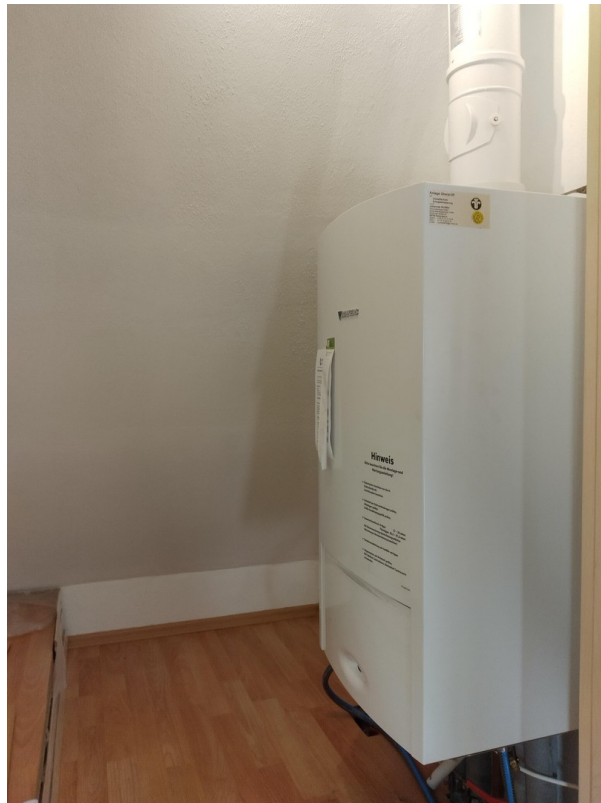
Heizungsraum im OG Anbau EFH
