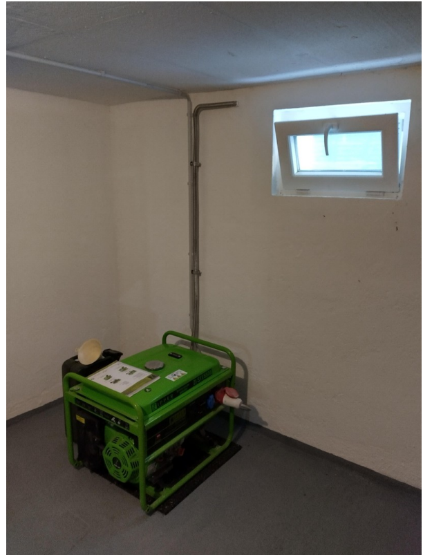
5 KW Strom-Aggregat im Keller
