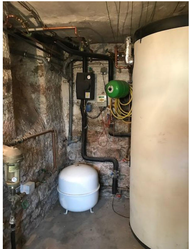
Technikkeller Solarregler, etc
