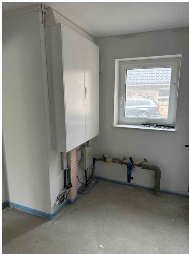
HWR Technikraum EG
