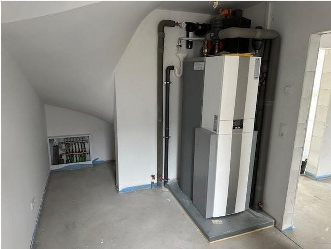
HWR Technikraum EG
