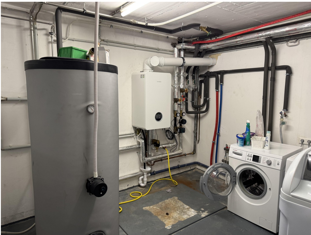
Heizung Hybrid + E Heizstab
