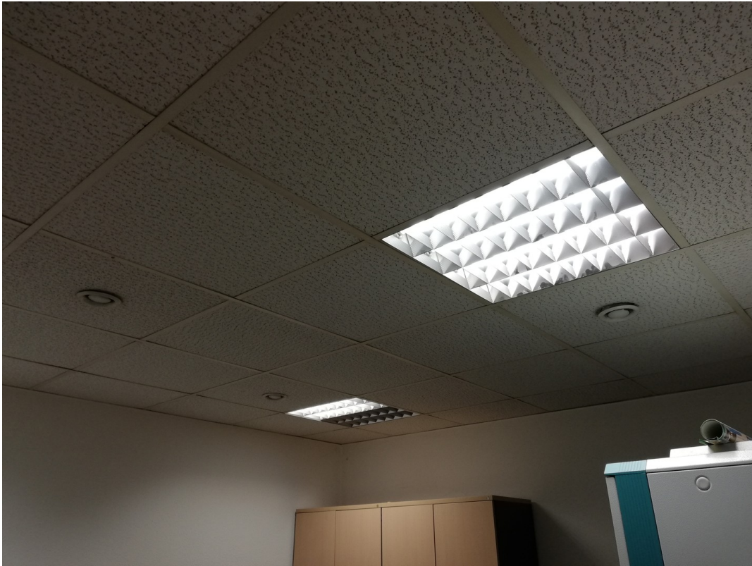
Beleuchtung und Belüftung
