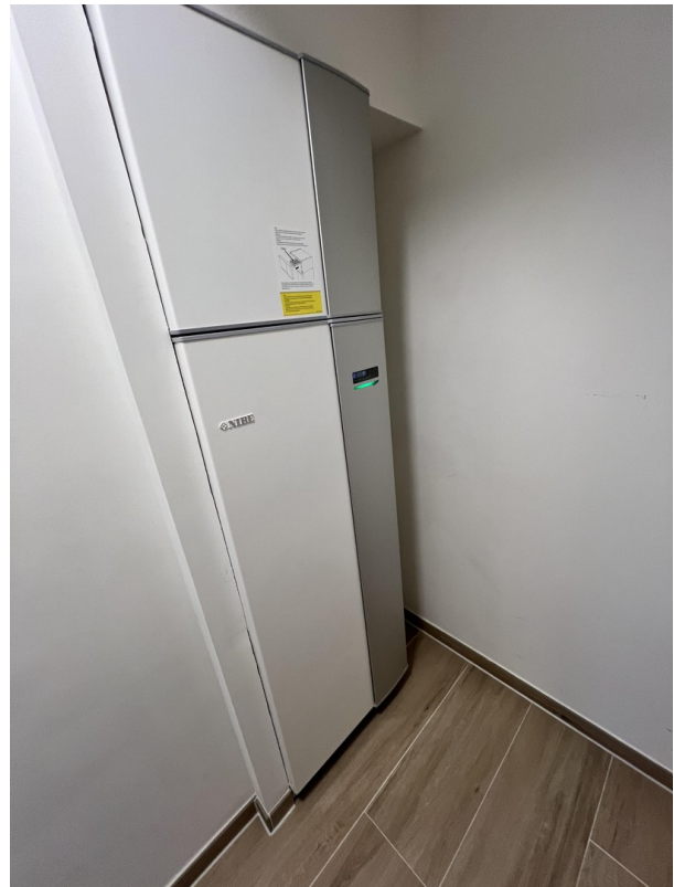
eigene Luft-/Wärmepumpe Etage
