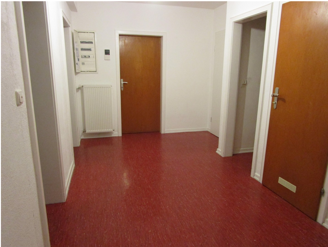
Flur, Sicherungskasten, Türöff
