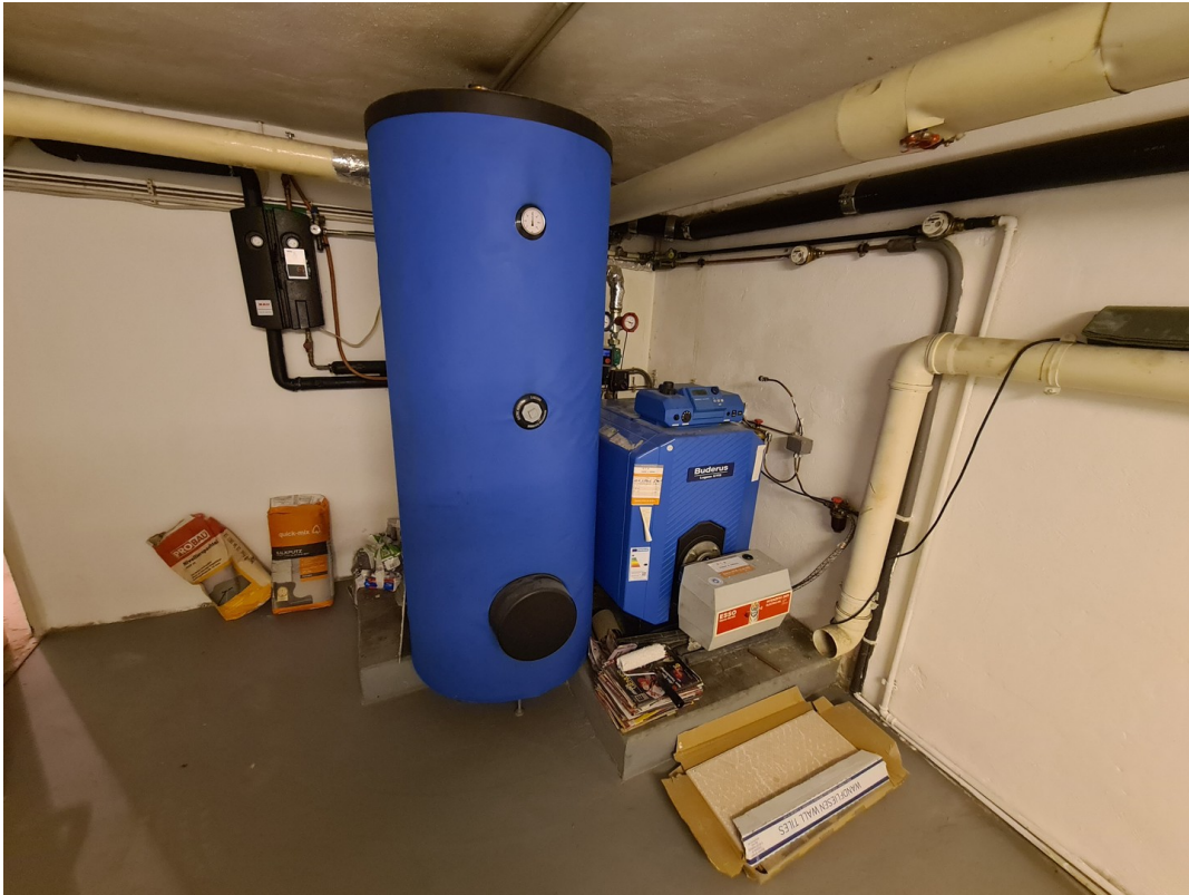
Ölheizung mit Solarthermie
