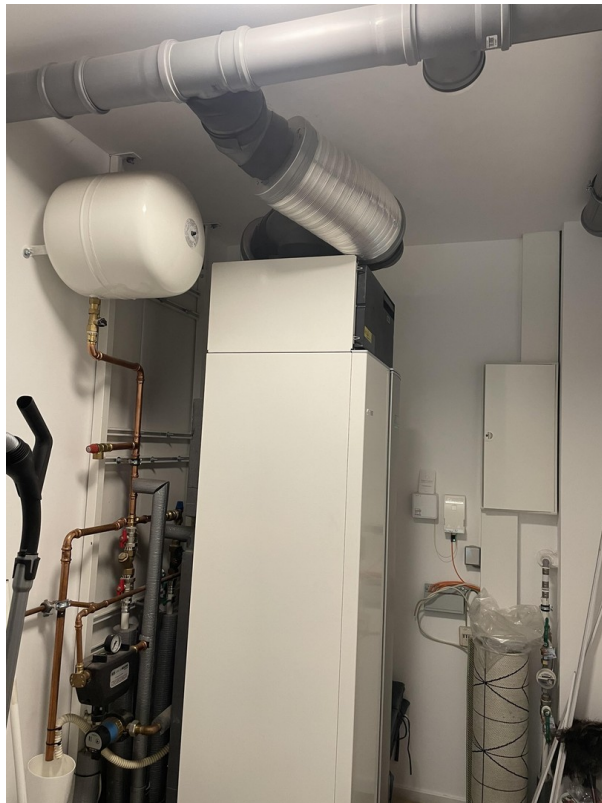
Abstellr. mit Luft-Wärme-Pumpe
