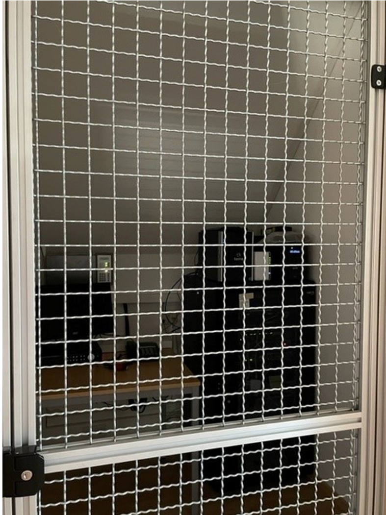
verriegelbarer Serverraum OG
