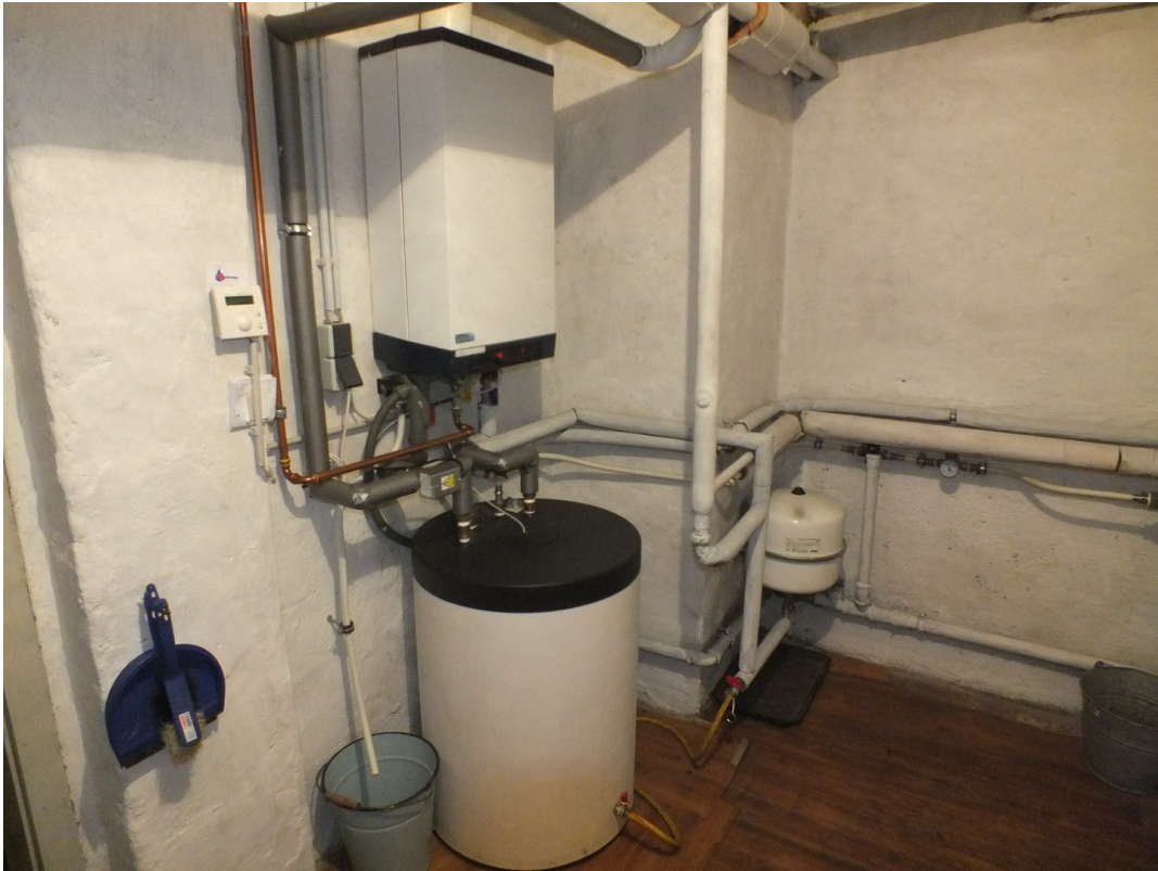
Heizraum im Keller
