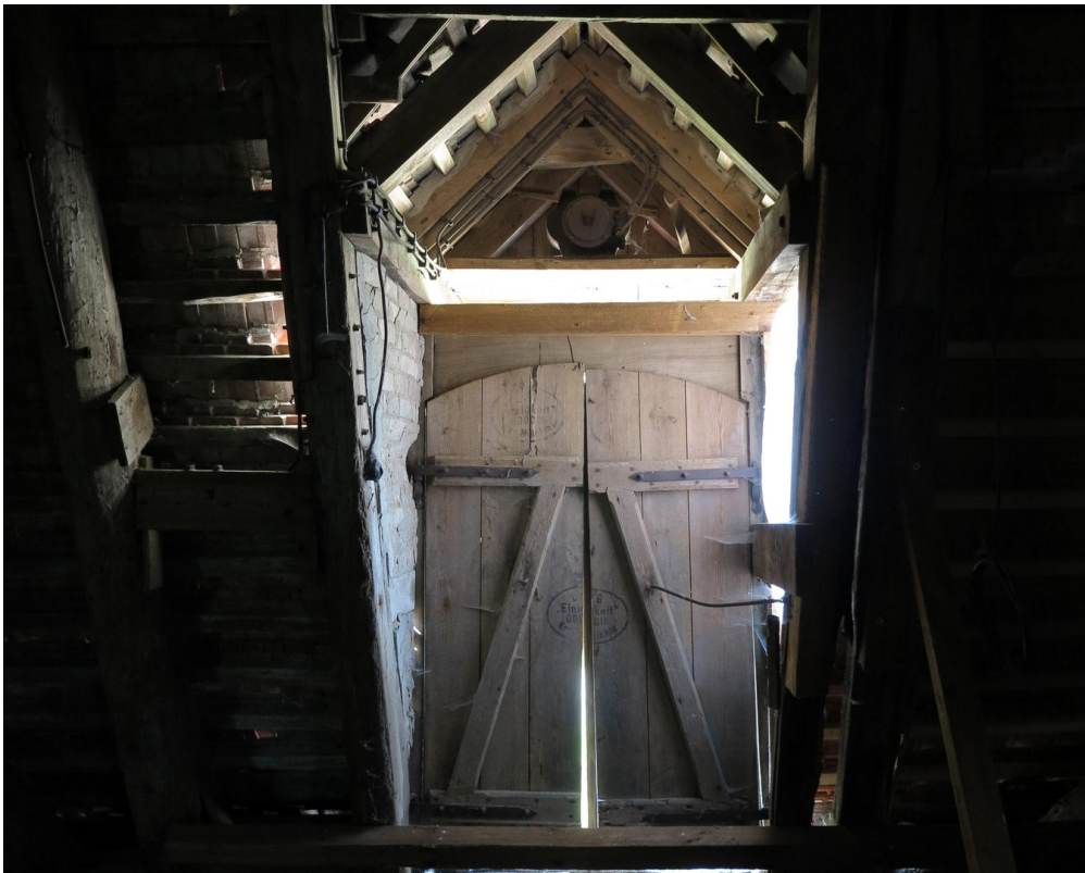
eines der beiden Krantore DG
