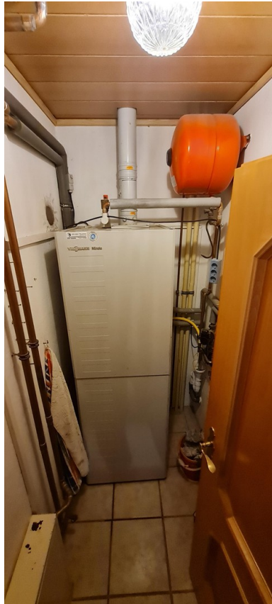
Heizung Viessmann EG
