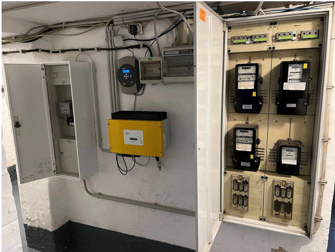
Keller Elektro- und PV-Anlage
