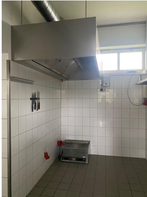
Küche mit Abluftanlage
