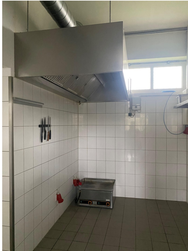
Küche mit Abluftanlage
