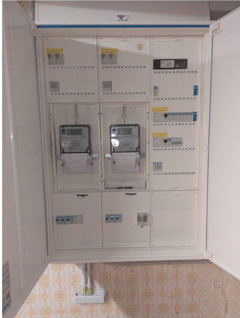
Zählerkasten im Heizungskeller
