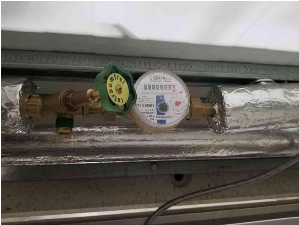
Kaltwasserleitung mit Zähler
