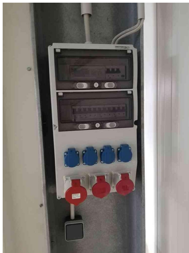
Stromunterverteilung mit Zähle
