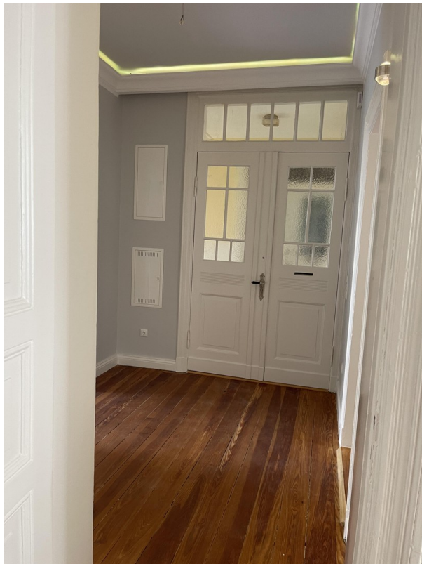
2 x Sicherungskasten mit IT
