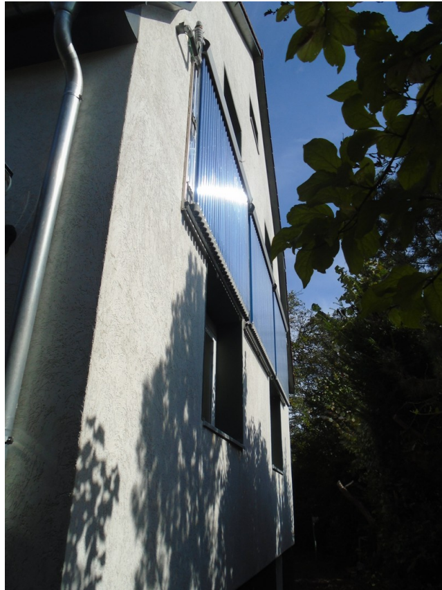
Südseite mit Röhrenkollektoren
