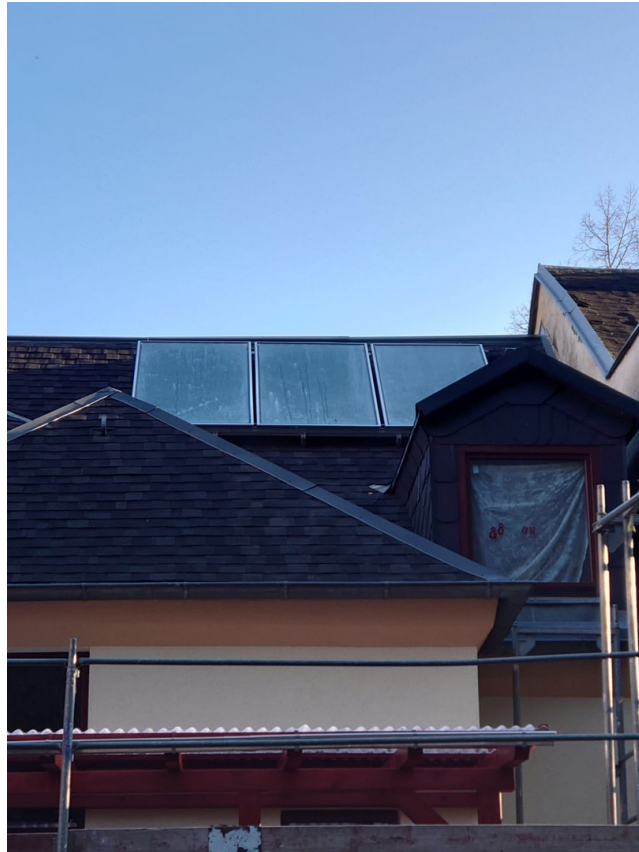
Dach mit Solar - Detail
