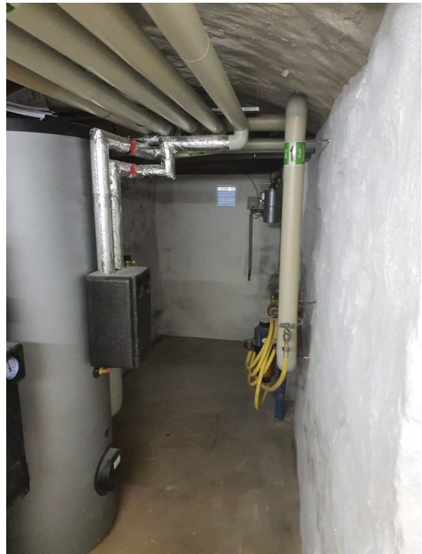
Neue Heizungsanlage - Detail
