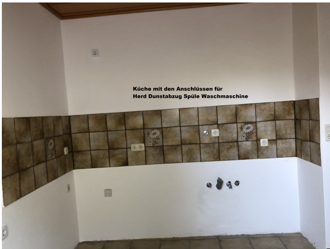
Küche mit Anschlüssen
