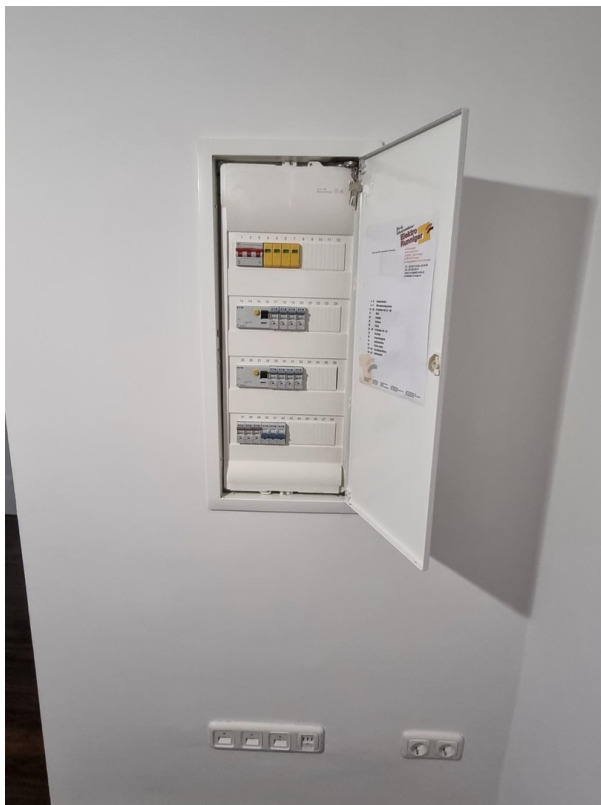
Neue Elektrik m. Datendosen
