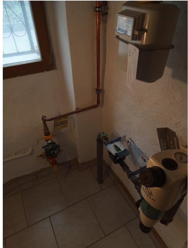
Gas- und Wasseranschluss
